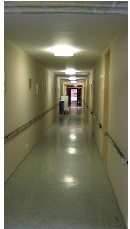
Bild 13: Flur mit schlechtem Beleuchtungsniveau: Die Beleuchtung spiegelt sich im Boden wider.
